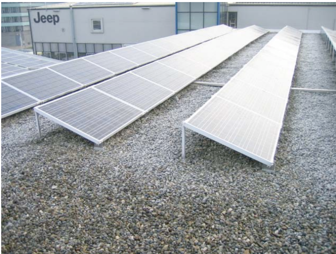
Bild 10. Ansicht der Anlage von der Seite.
