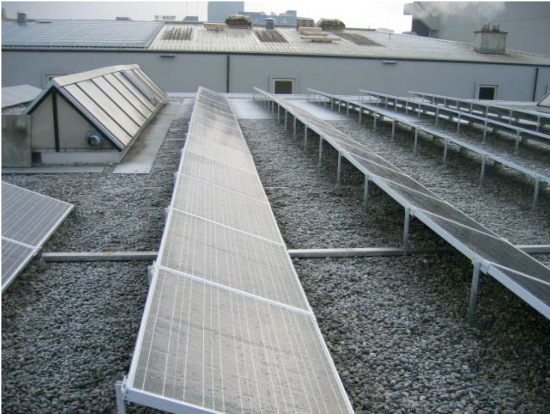
Bild 17. Fertig montierte P+D Anlage von der Seite.
