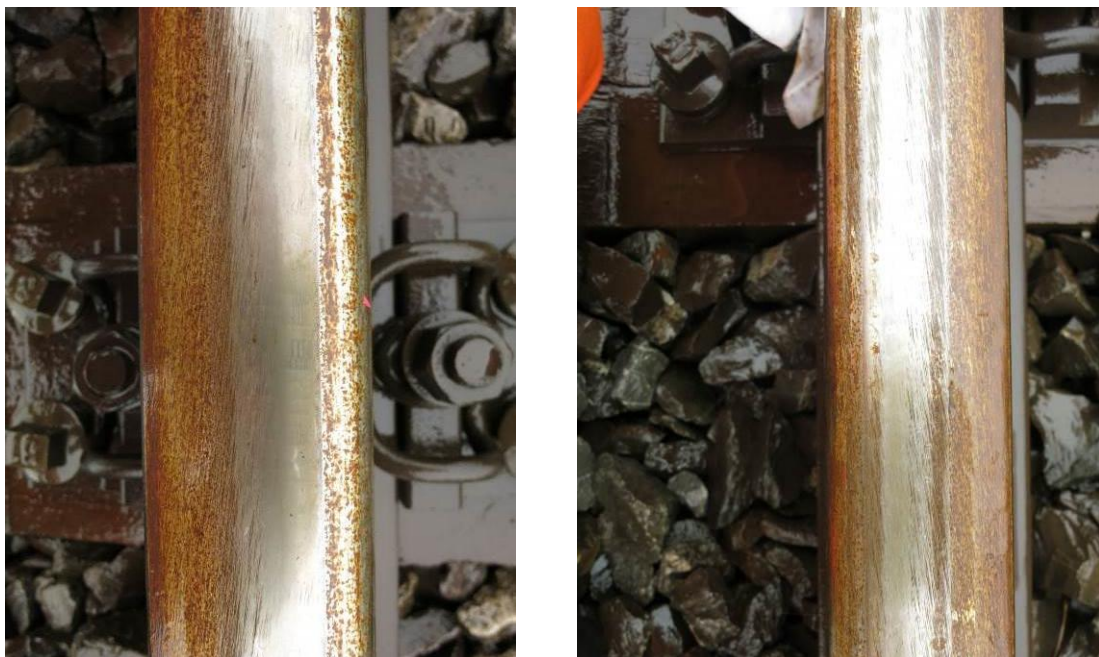
Abbildung E-2 links: Südliche Schiene, rechts: Nördliche Schiene
