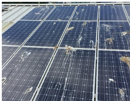
Abbildung 4.2.3 PV Module durch Vogelkot verschmutzt. Quelle [35]
