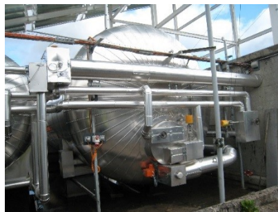
Vue de face de la cuve bitume
