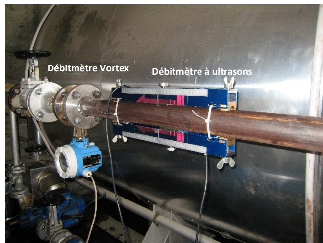
Figure 20 : Circuit chaudière – Mesure du débit avec un débitmètre à ultrason portable
