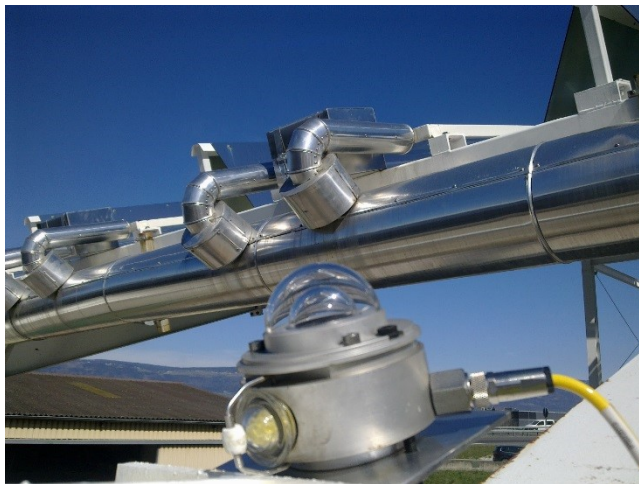
Figure 11 : Pyranomètre installé sur l'installation solaire de Pittet-Chatelan
