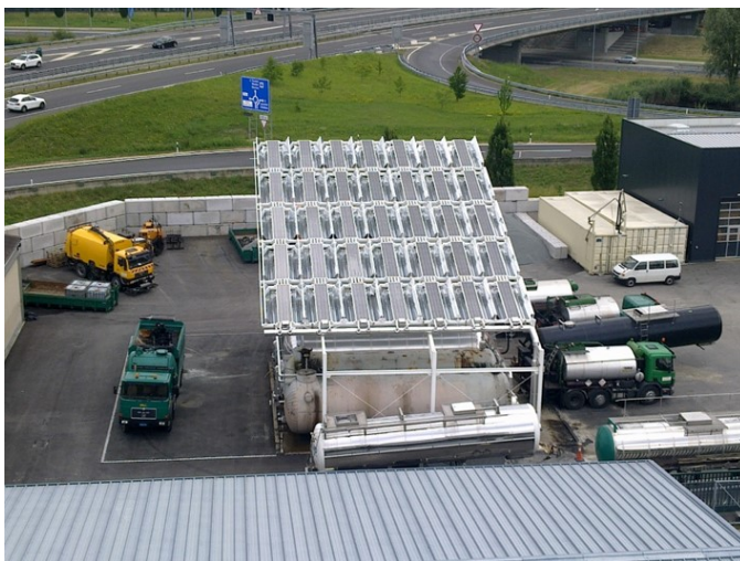
Figure 18: Emplacement du champ solaire
