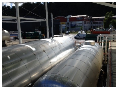
Vue des cuves (à gauche bitume; à droite eau)
