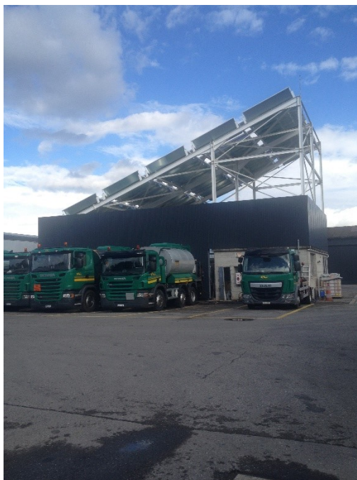
Figure 10 : Vue de l'installation avec fermetures métalliques sur le bas de l'installation
