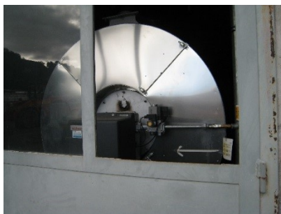
Vue de la chaudière
