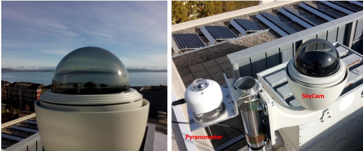
Abb. 2: SkyCam und Pyranometer Installation am CSEM Neuenburg
