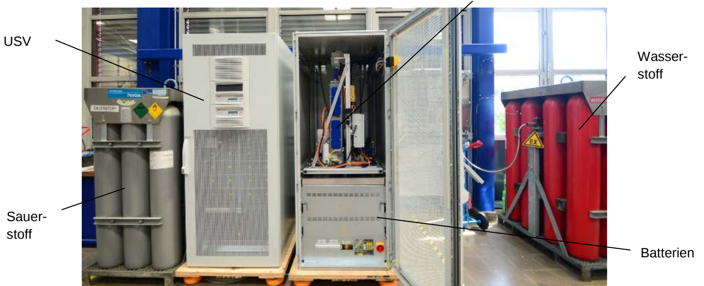
Abbildung 5: Aufbau der Anlage gemäss Systemarchitektur 1: Rack 1 mit den zwei UPS Modulen (links), Rack 2 mit Brennstoffzellensystem und Batterien (rechts).
