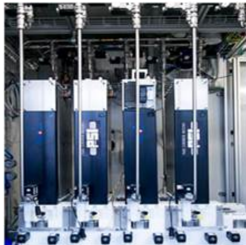
Abbildung 22: Einbau von vier Swiss Hydrogen Brennstoffzellen-Modulen mit neuem Design im ESI-Projekt
