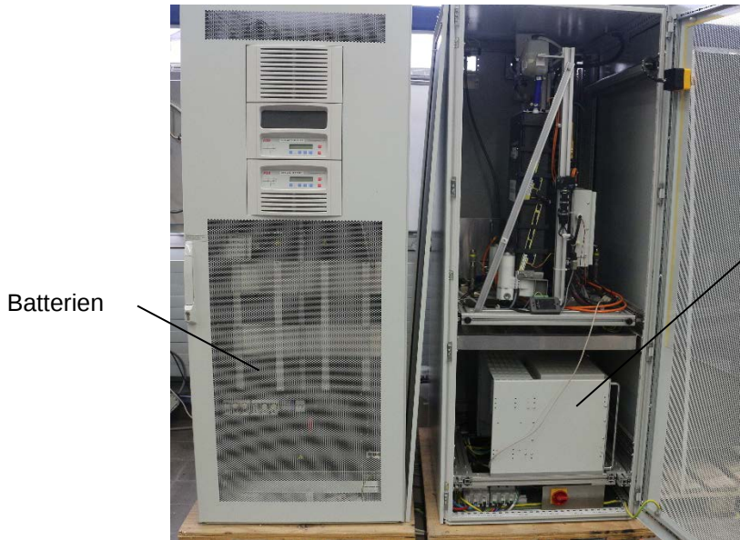
Abbildung 7: Rack 2 der Systemarchitektur 2 mit Brennstoffzellensystem und DC-DC Wandlern
