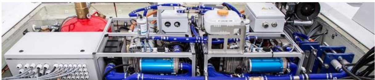
Abbildung 24: Eingebautes Brennstoffzellsystem im Solarboot
