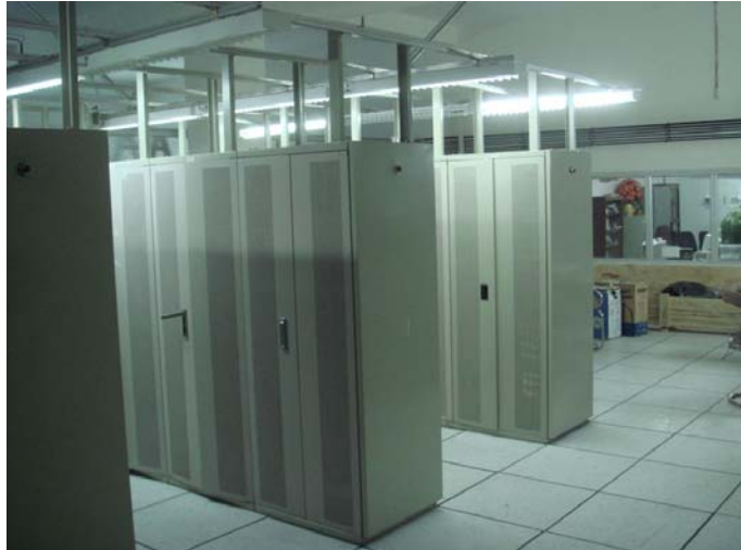
Abb. 5.9: Freistehende Schaltschränke mit Deckenverankerung (Foto Studer)
