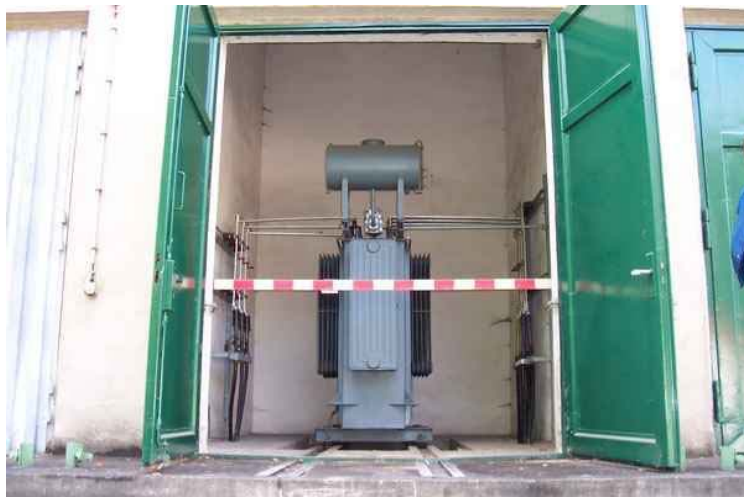
Abb. 3.20: Transformator auf Schienen gelagert, ohne ausreichende Kipp- und Rollssicherung ( http://www.obus-ew.de/ )
