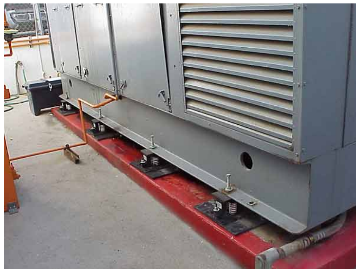
Abb. 20: Seismische Isolation eines Notstromgenerators. ( http://www.etccd.com )
