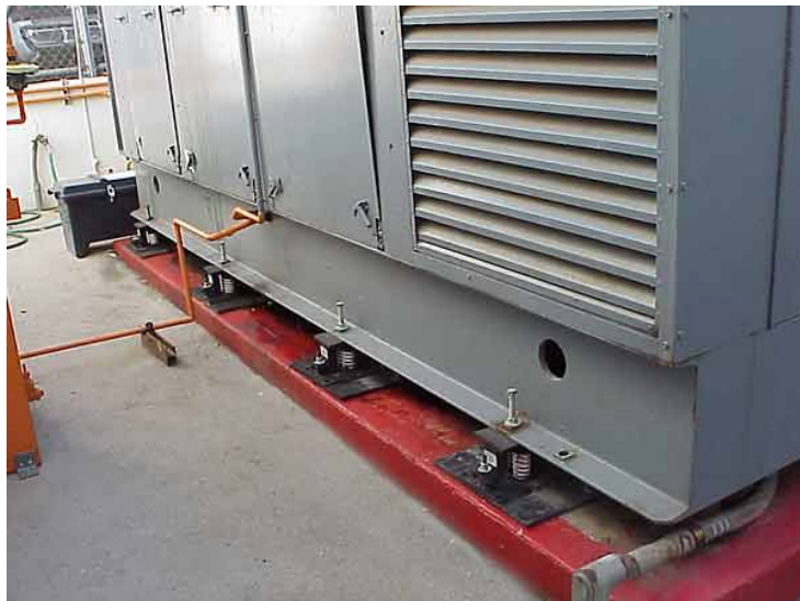
Abb. 5.21: Seismische Isolation eines Notstromgenerators. ( http://www.etcdd.com )
