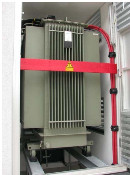
Abb. 5.16: Transformator auf Schienen gelagert mit Kipp- und Rollssicherung
