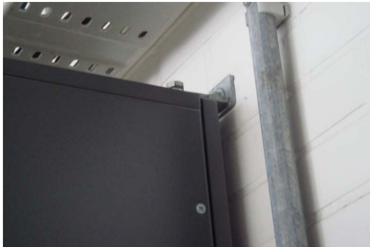
Abb. 5.10: Verankerung eines Schaltschranks an einer tragenden Wand (Foto Weber)
