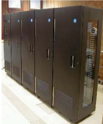
Abb. 3.19: Freistehender gegen Kippen ungesicherter Kontrollschrank (Uni Freiburg)
