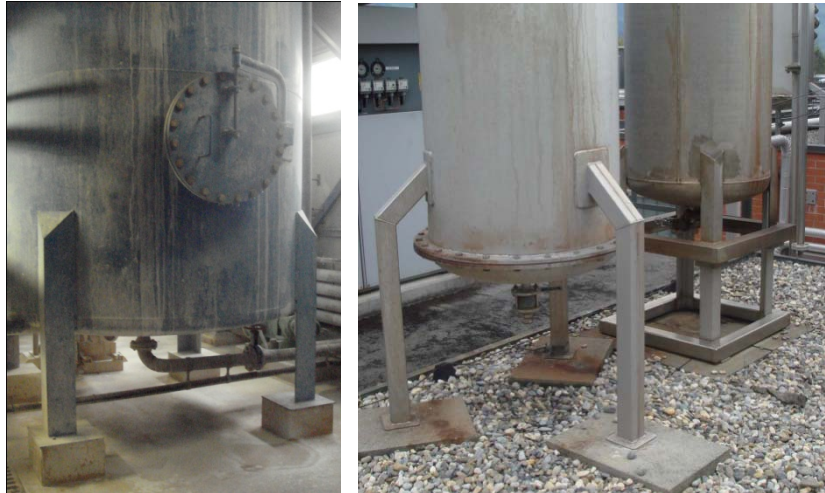
Abb. 3.16: Nicht ordnungsgemäss verankerte Behälteraufstellung, Gefährdung durch Umkippen und Verschieben (Foto Studer / Weber)
