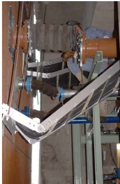
Abb. 3.7: Rohrleitungsabriss gelenkiger Verbindungen durch sehr grosse Deformationen bei der Kashiwazaki Kläranlage beim Niigata Chuetsu Oki Erdbeben 2007 (Kayen et al. 2007)
