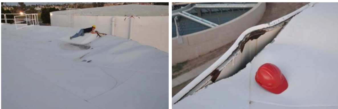
Abb. 3.12: Tankschäden der Kläranlage in Calexico Mexico beim Sierra El Mayor Erdbeben 2010 (Hutchinson et al. 2010)
