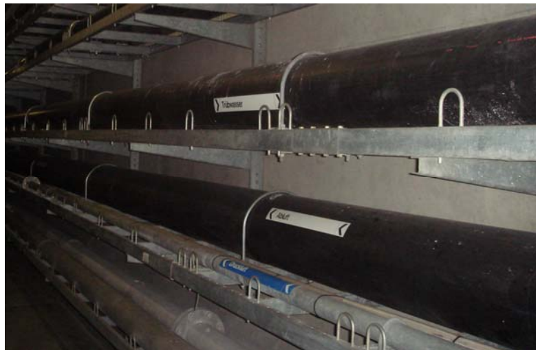
Abb. 3.17: Erdbebenerechte Rohrleitungshalterungen in Querrichtung, zusätzliche Halterungen der Konsole in Längsrichtung sind jedoch erforderlich (siehe Abb. 5.7a), Gefährdung durch Abreissen und starke Deformationen in Längsrichtung (Foto Studer)
