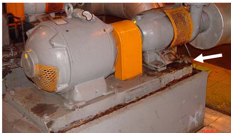
Abb. 3.18: Korrodierte oder schlechte Befestigung bzw. Verankerung von Pumpenanlagen (ALA 2004)
