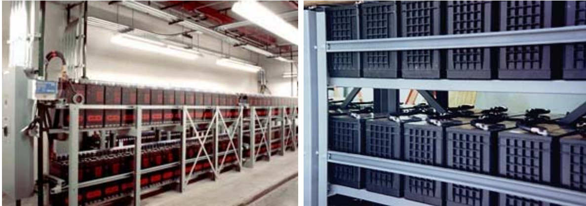
Abb. 19: Erdbebungerechte unabhängige Stromversorgung mit Sicherung der Batterien gegen Umkippen und Herausfallen (JMAEG, Phasor Corporation)
