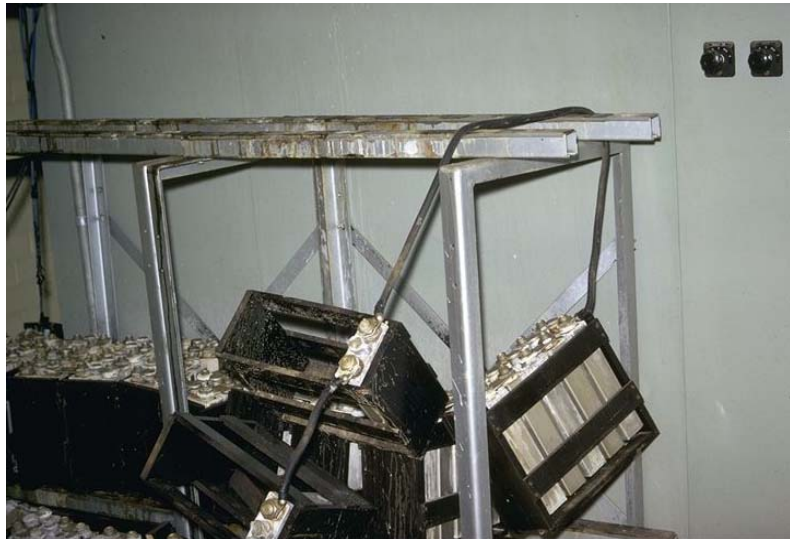
Abb. 3.13: Versagen der unabhängigen Stromversorgung durch umfallen der Batteriehalterung beim San Fernando Erdbeben 1971 (Foto Steinbrugge)
