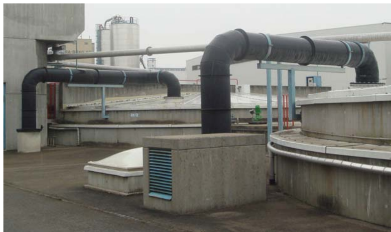
Abb. 3.15: Ungünstige auskragende unsymmetrische Rohrleitungshalterungen, Gefährdung durch Abreissen und starke Deformationen (Foto Studer)
