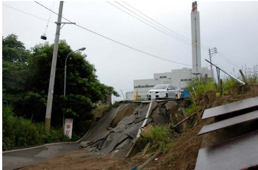
Abb. 3.5: Erdbeben an der Zufahrtstrasse nach Kashiwazaki beim Niigata Chuetsu Oki Erdbeben 2007 (Kayen et al. 2007)
