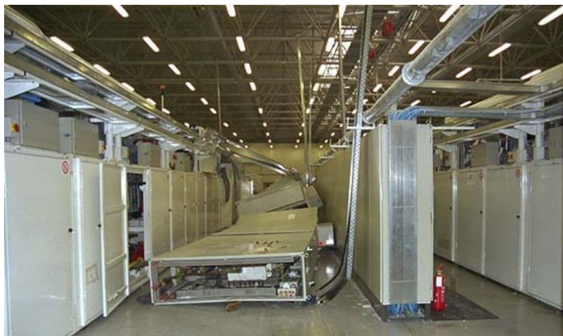
Abb. 3.14: Umgestürzter Schaltschrank beim Izmit Erdbeben 1999 in der Türkei (Foto Sezen)
