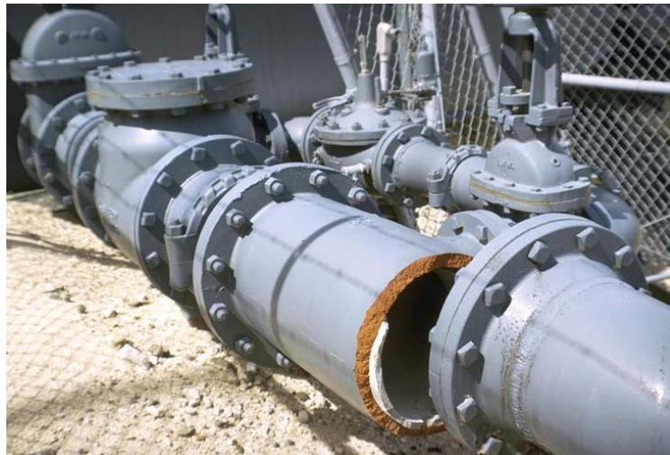
Abb. 3.1: Bruch spröder Wasserrohre einer Tankanlage beim San Fernando Erdbeben 1971 (NISEE 2010)
