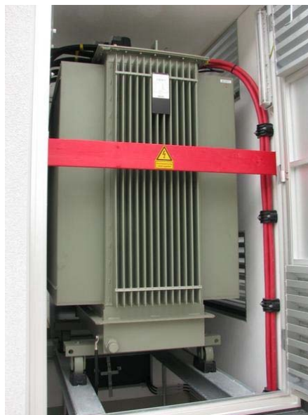
Abb. 18: Transformator auf Schienen gelagert mit Kipp- und Rollsicherung
