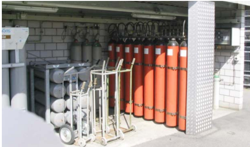
Abb. 5.13: Gegen Umfallen gesicherte Gasflaschen (Foto Studer)
