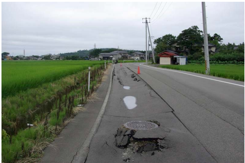
Abb. 3.6: Bodenverflüssigung im verfüllten Rohrgraben, Aufschwimmen des Schachtes und Sackungen durch Verdichtung des Füllmaterials (Kayen et al. 2007)
