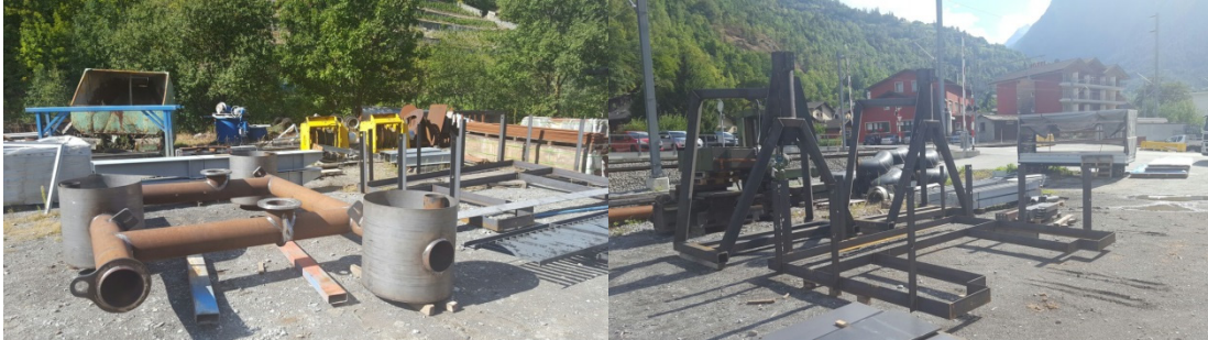
Figure 18 Fabrication et montage de la plateforme sur le site de l'entreprise Stahleinbau AG. 27.09.2016.
