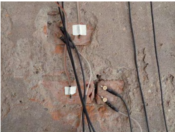
Abbildung 20: Einbauort Südwestwand mit 1x Temperatur/rel. Feuchte Sensor im Mauerwerk (70 mm Tiefe), 2x Temperatur/rel. Feuchte Sensor Oberfläche Mauerwerk, 2x Sonden zur Messung der Materialfeuchte im Mauerwerk (70 mm Tiefe).
