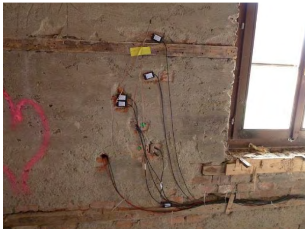
Abbildung 21: Gesamtansicht Einbauort Sensoren Südwestwand mit Kabeldurchführung nach aussen zu externen Sensoren.
