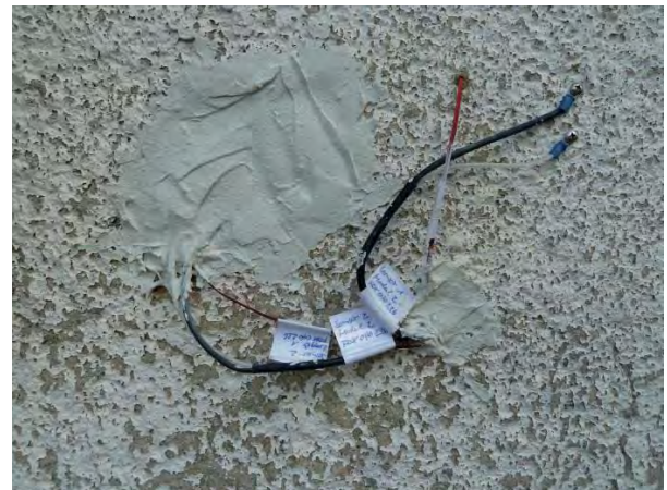
Abbildung 25: Endzustand Einbauort Sensoren Südwestwand.
