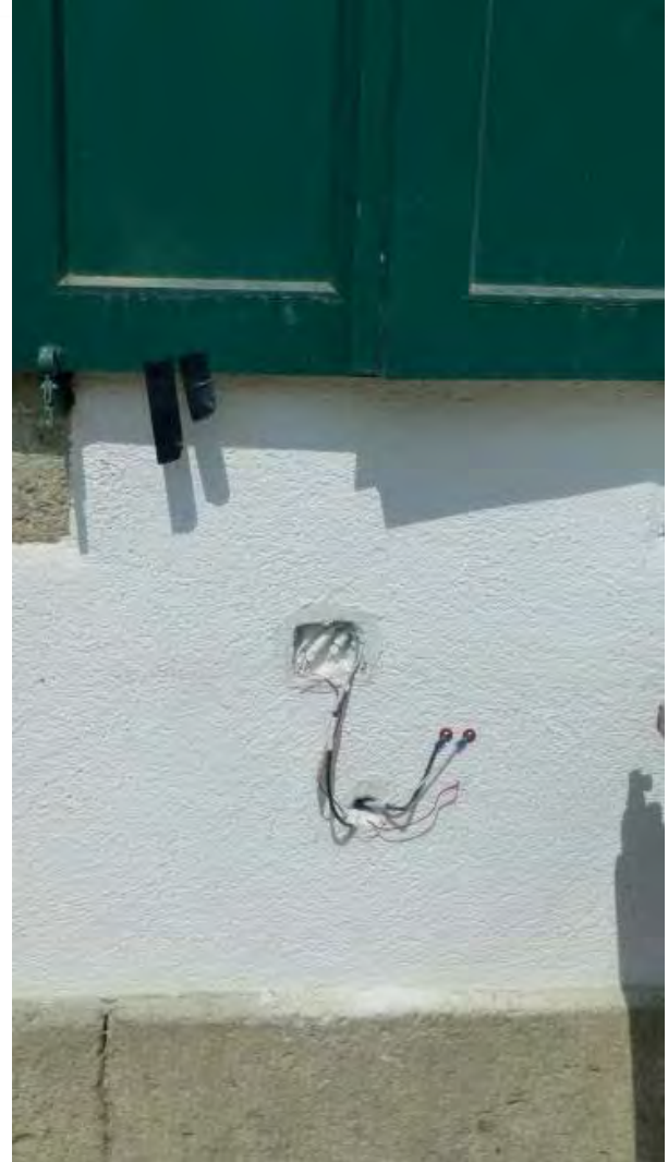
Abbildung 44: Aussenwand Südwest nach Installation der Sonden zur Messung der Materialfeuchte und Temperatur im Aussenputz und Mauerwerk (70 mm Tiefe).
