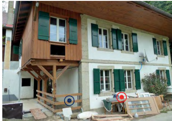
Abbildung 36: Ansicht der Einbauorte der Sensoren für das Messobjekt Brüttelen. Blau: Nordwestwand. Rot: Südwestwand
