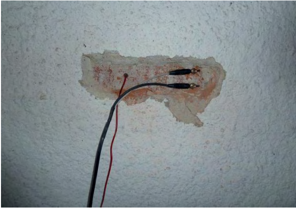
Abbildung 26: Aussenansicht Einbauort Sensoren Nordwestwand. Temperatur Sensor Mauerwerk (70 mm Tiefe), Sonden zur Messung der Materialfeuchte im Mauerwerk (70 mm Tiefe).
