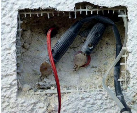
Abbildung 43: Temperatursensor und Sonden zur Messung der Materialfeuchte im Mauerwerk (70 mm Tiefe) bei geöffnetem Putz.
