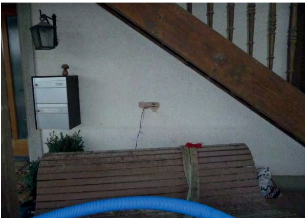
Abbildung 28: Aussenansicht Einbauort Sensoren Nordwestwand mit Temperatur Sensor Mauerwerk (70 mm Tiefe) und Sonden zur Messung der Materialfeuchte im Mauerwerk (70 mm Tiefe).
