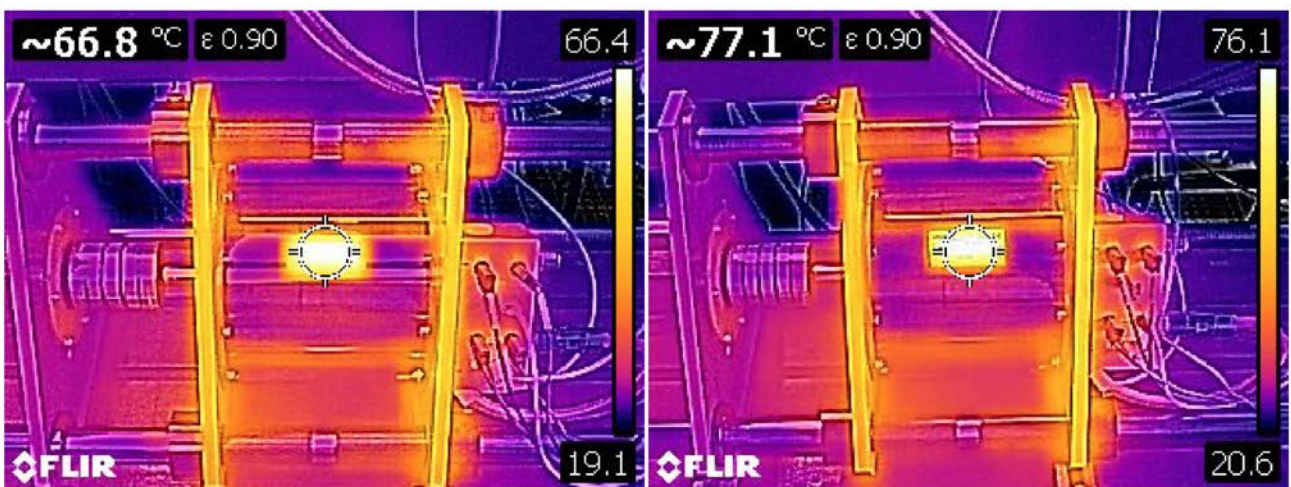
Figure 3.41 : Photos infrarouges à l'équilibre thermique pour un courant de 3.5 [A] et 4.1 [A]
