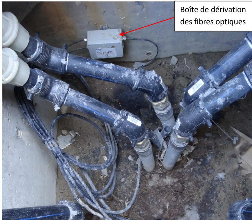
Figure 16 : Chambre de sonde avec raccordement des fibres dans la boîte de dérivation
