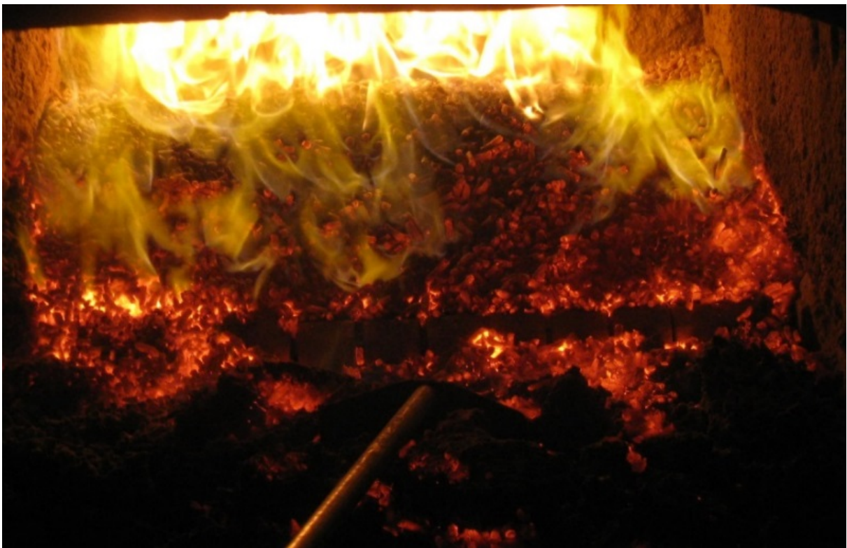
Abbildung 26: Blick in den Brennraum des Schmid-Heizkessels
