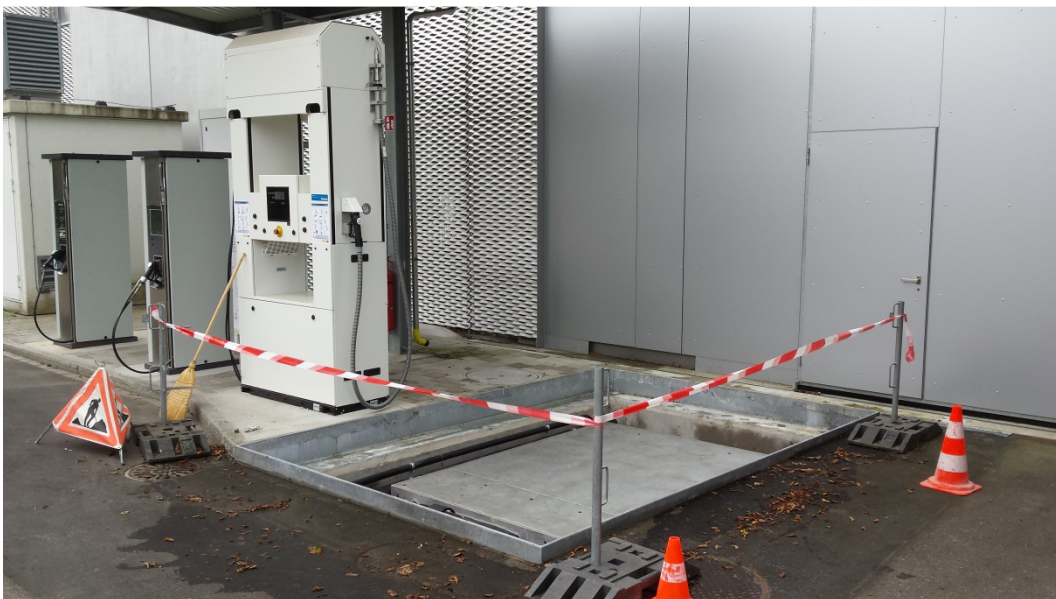
Abb. 3 Positionierung von Verdichter (o.l.), Kältekompressor (o.r.) und Wärmetauscher im Betonschacht (u.)
