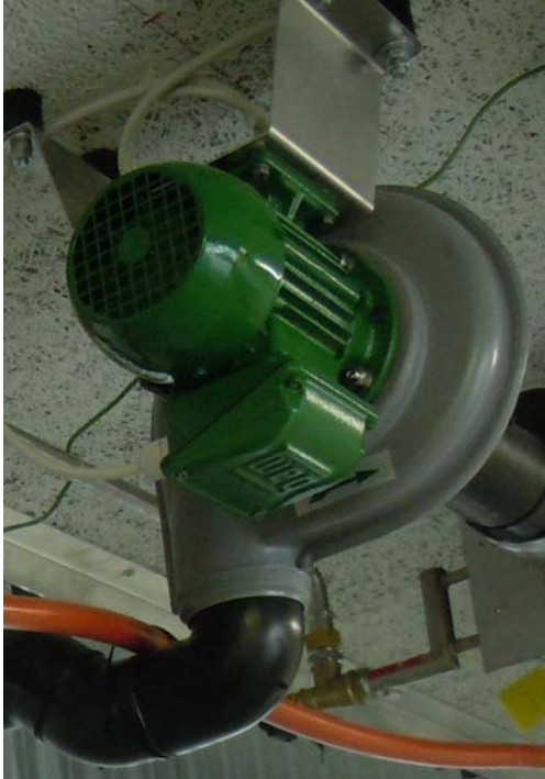
Abb. 27 Ventilator zur Umwälzung der Luft (montiert an der Garagendecke ausserhalb des Speichers).
