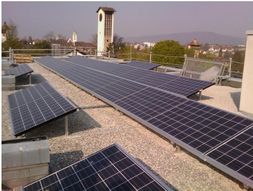
Abbildung 8: Photovoltaik-Anlage Alters- und Pflegeheim Rheinfelden, 31 KWp, Inbetriebnahme Mai 2010
