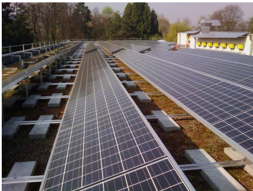
Abbildung 9: Photovoltaik-Anlage Parkhaus Kurzentrum, 60 KWp, Inbetriebnahme Mai 2010
