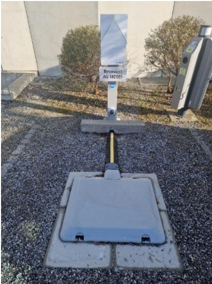
Abbildung 3: Induktives Ladesystem von WiTricity (Ground Pad, Wall Box & Verkabelung)
