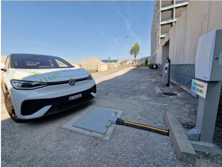
Abbildung 46: Fertigestellte induktive Ladestation bei Eniwa in Buchs
