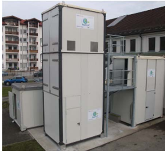
Abbildung 9 Pilotanlage BlueFlux Anlage
