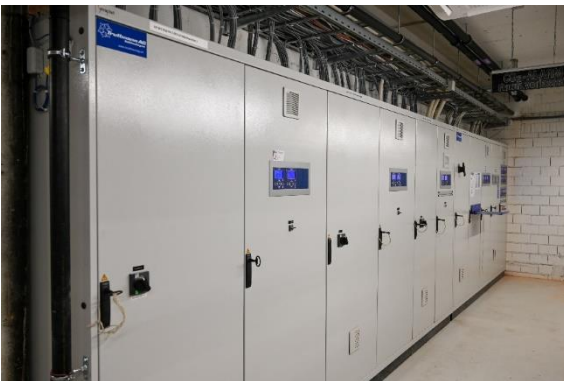
Abbildung 10: Elektro- und Steuerungsschrank.
