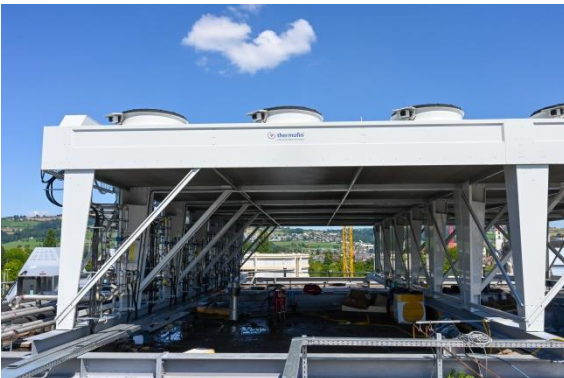
Abbildung 8: Gaskühler mit Wärmepumpen-Verdampfer.
