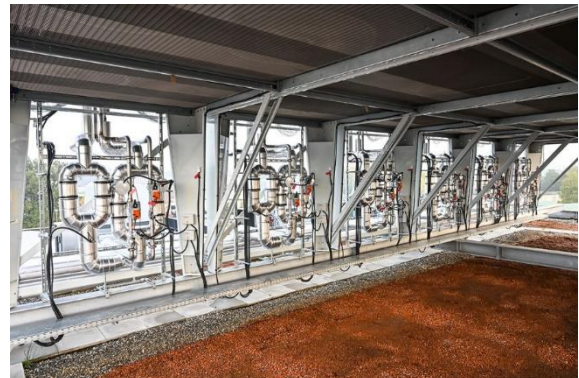
Abbildung 7: Anschluss Gaskühler und Wärmepumpen-Verdampfer.
