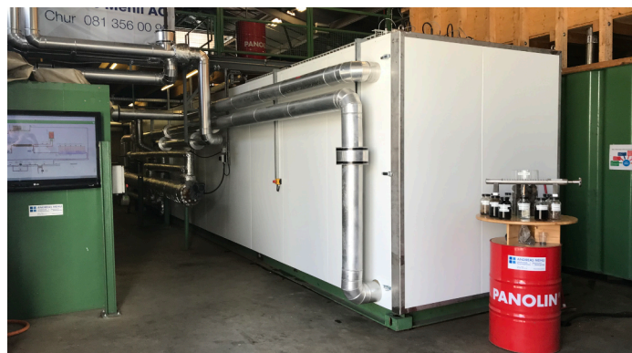
Über das isolierte vertikale Rohr im Vordergrund gelangt der auf 200 °C erhitzte und auf 20 bar komprimierte Klärschlamm in den HTC-Reaktor (weisser Container). Dort verwandelt sich der Klärschlamm in einem nur vier Stunden dauernden Prozess in Kohleschlamm, aus dessen Feststoffen anschliessend durch Pressung HTC-Kohle gewonnen wird. Foto: BFE-Schlussbericht
