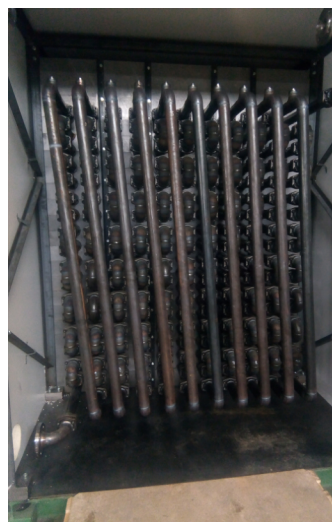
Der Karbonisierungsreaktor besteht aus einem Rohr, das in elf Schleifen von jeweils zwölf Metern Länge angeordnet ist und insgesamt 5600 l Schlamm fasst. Der Reaktor ist sehr gut isoliert, so dass der Schlamm auf seiner vierstündigen Reise durch das Reaktorrohr nur 10 Grad (von 200 auf 190 °C) abkühlt. Im Reaktor verwandelt sich der Klärschlamm in Kohleschlamm, der nach dem Verlassen des Reaktors in einem Wärmetauscher auf 60 °C abgekühlt und in einer Schneckenpumpe entspannt wird. Foto: BFE-Schlussbericht
