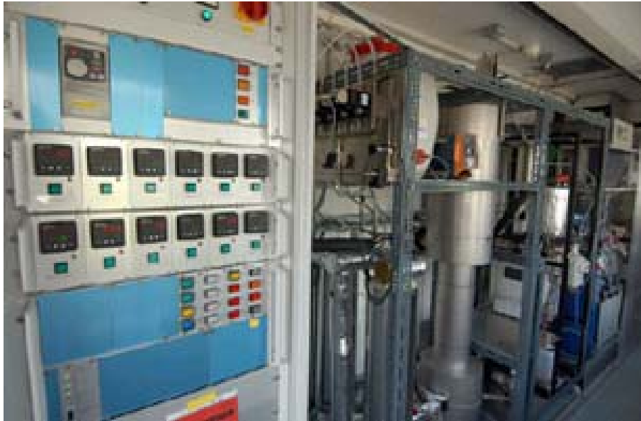
Abb. 13 Ansicht der Versuchsanlage COSYMA im Container (Steuerung, Gasreinigung, Methanierung, Produktgaskühler und Onlinegasdiagnostik)
