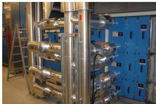
Figura A1.21 : Dettaglio impianto di climatizzazione.
