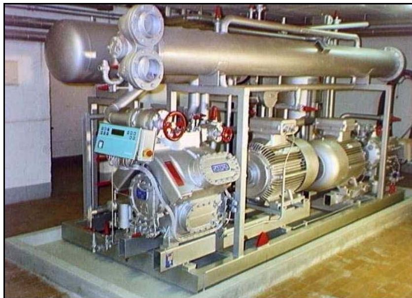
Abbildung 5: Elektrowärmepumpe noch ohne Schallschutzhaube
