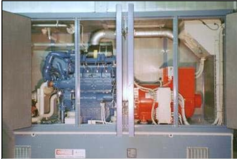
Abbildung 7: Blockheizkraftwerk mit geöffneter Schallschutzhaube
