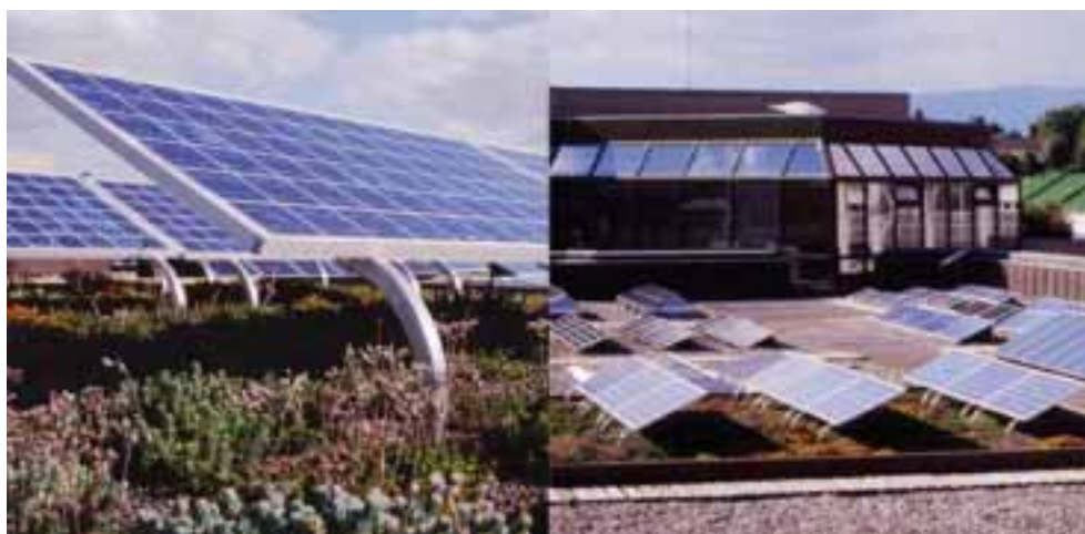
ill. 2: Installation photovoltaïque de toiture-jardin avec Solgreen, à l'EPF de Lausanne Photo: LESO-EPFL
