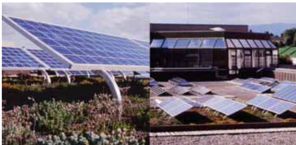
Bild 2: Gründach Photovoltaik Anlage mit Solgreen an der EPF Lausanne Foto: LESO-EPFL
