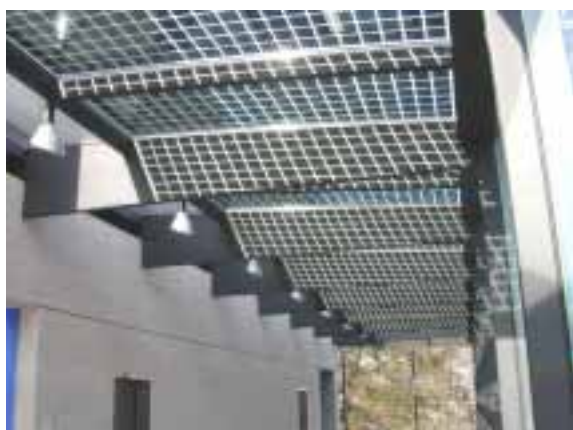
Bild 8: Isolierglasmodule Kantonsschule Stadelhofen, Foto: NET AG
