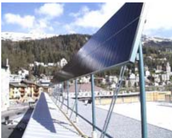
Bild 12: Anlage in St. Moritz mit CIS Modulen (Bildquelle: TISO)
