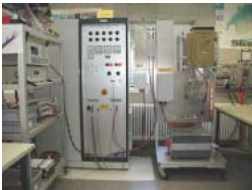
Bild 5: PV-Generator-Simulator 25 kW (HTA Burgdorf), (Bildquelle: HTA Burgdorf)
