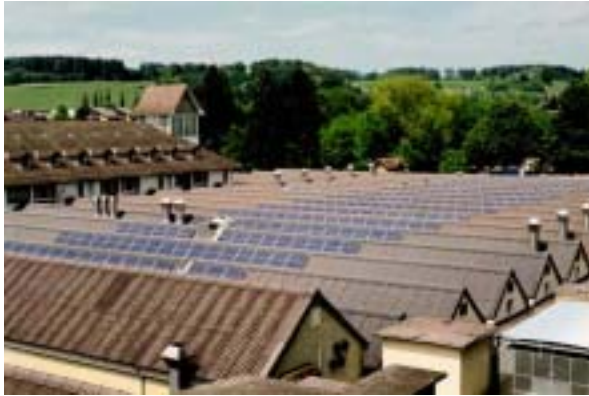
Bild 18: Anlage Felsenau mit LON Überwachung (Bildquelle: NET AG)
