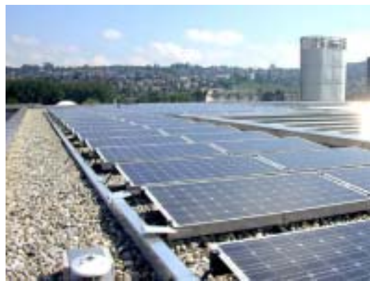
Bild 21: Flachdachanlage IBM Zürich (Bildquelle: NET AG)
