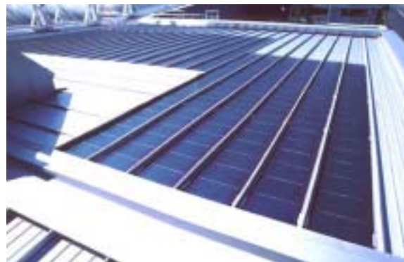
Bild 15: PV Eurodach amorph Flumroc (Bildquelle: NET AG)
