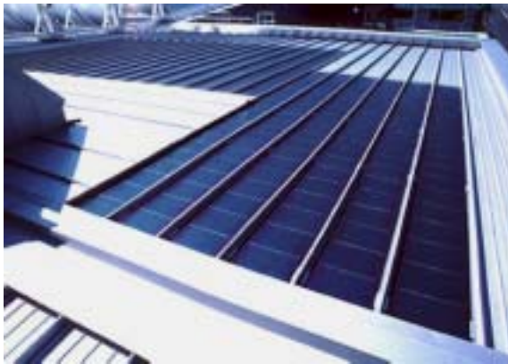
Figure 32: „Euro-toiture“ PV de 3 kW c au silicium amorphe (Photo: NET)
