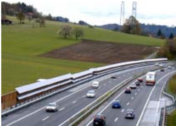
Figure 34: Installation de 75 kW c de l'A1 à Safenwil (AG), montée sur des parois anti-bruit (Photo: OFEN)
