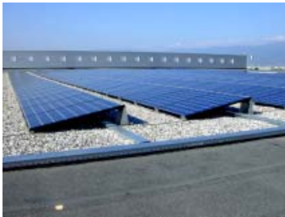
Figure 24: Installation de 70 kW c sur le toit plat de Palexpo, à Genève (Photo: NET)
