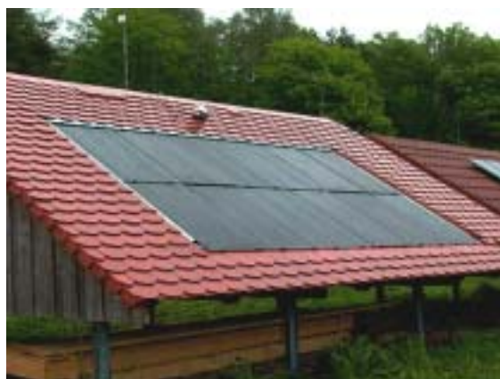
Figure 5: Installation de démonstration pour l'essai d'éléments CIS en plein air, dans le cadre du projet HIPERB (Photo: 3S)
