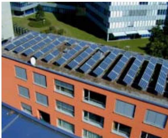
Figure 28: Centrale Solgreen 1 intégrée à une toiture-jardin, à Zurich (Photo: NET)
