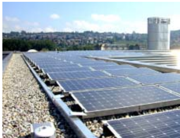
Figure 29: Installation IBM de 47 kW c en toiture plate, à Zurich (Photo: NET)
