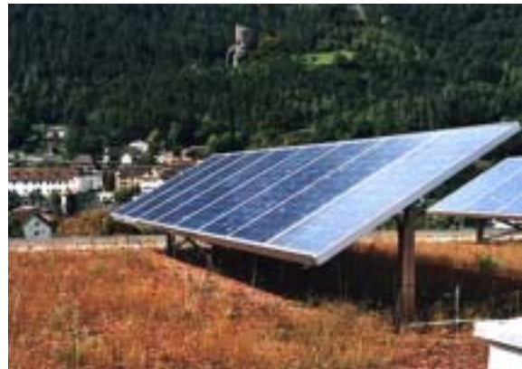
Figure 33: Installation Solgreen de 10 kW c intégrée à une toiture-jardin, à Coire (Photo: NET)
