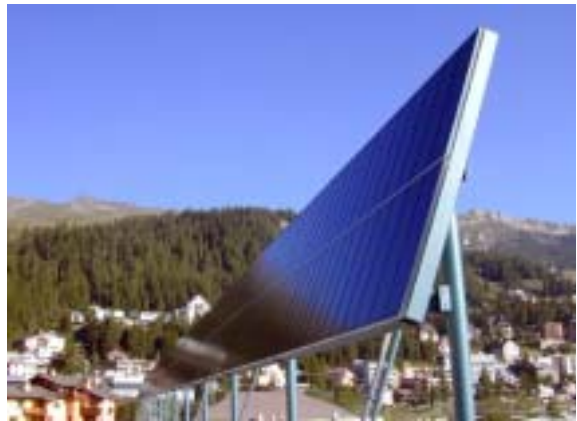
Figure 35: Installation de 16.8 kW c à modules CIS, à St-Moritz (Photo: NET)
