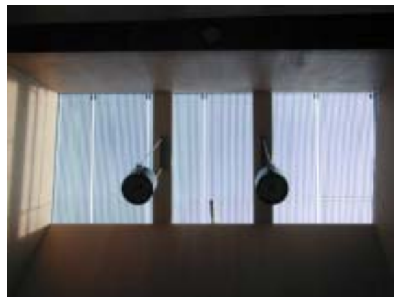
Figure 23: Installation photovoltaïque pare-soleil Würth , à Coire, vue de l'intérieur du bâtiment (Photo: NET)
