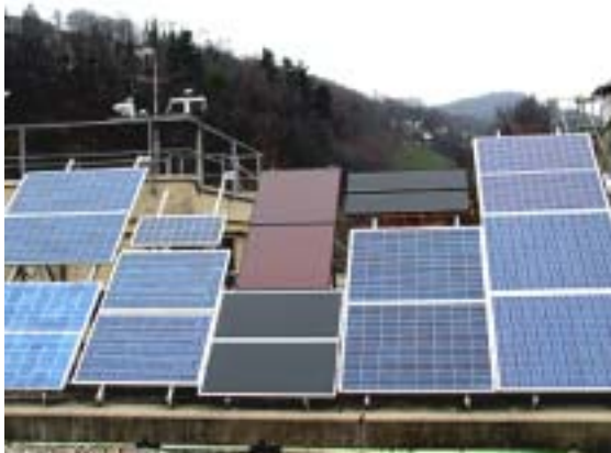
Figure 6: Le banc d'essai pour modules PV du TISO (Photo: LEEE-TISO)
