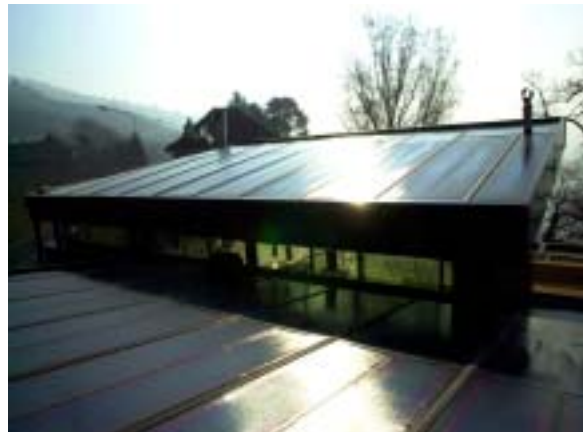
Figure 25: Intégration en toiture, système Freestyle®, à Lutry (VD) (Photo: Solstis)
