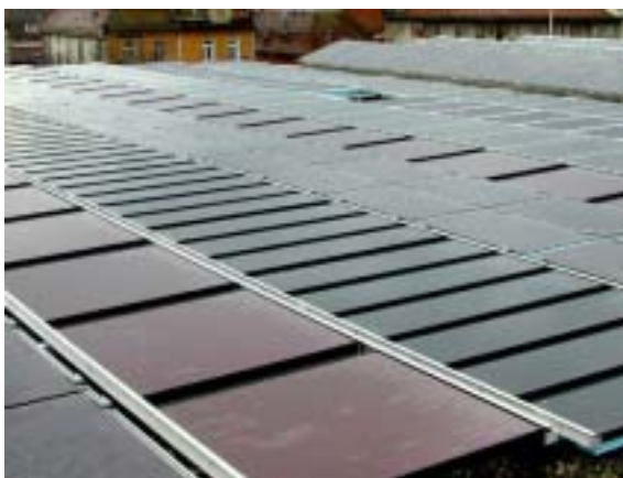
Figure 22: PV-DünnFilmTest à Zurich (Photo: NET)
