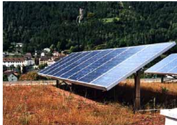
Figur 33: 10 kWp Gründachanlage Solgreen Chur (Bildquelle NET)
