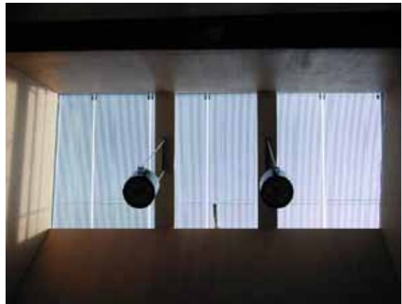
Figur 23: PV Beschattungsanlage Würth Chur, Sicht vom Gebäudeinnern (Bildquelle NET)
