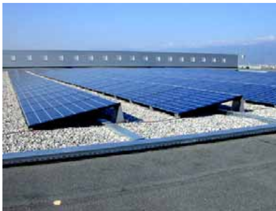
Figur 24: 70 kWp Flachdachanlage Paalexpo Genf (Bildquelle NET)
