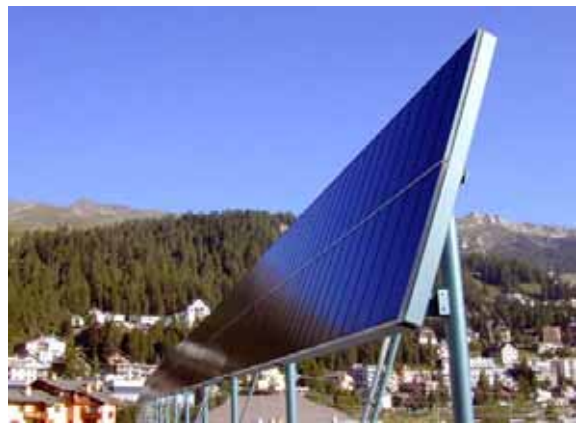
Figur 35: 16.8 kWp Anlage mit CIS Zellen St. Moritz (Bildquelle NET)
