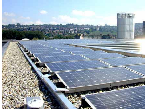
Figur 29: 47 kWp Flachdachanlage IBM Zürich (Bildquelle NET)
