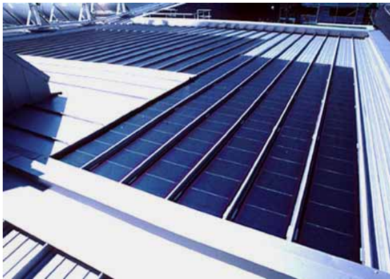
Figur 32: 3 kWp PV Eurodach mit amorphen Zellen (Bildquelle NET)
