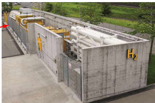
Abbildung 16: Wasserstofftankstelle in Brugg
