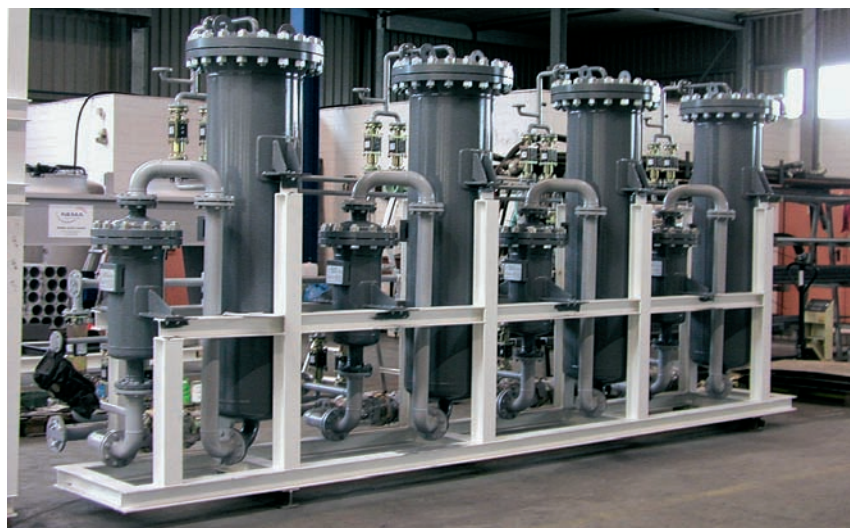
Abb. 4 4-säulige Druckwechseladsorptionsanlage (DWA).
