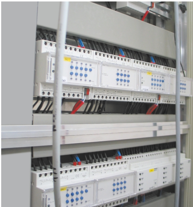
Zentrale Anordnung der Schaltaktoren im Elektroverteilkasten, wie hier im Smarthome Chur, bietet einige Vorteile BUS-House
